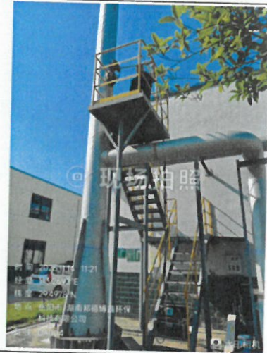
附图 2 甲类仓库排气筒出口 DA004
